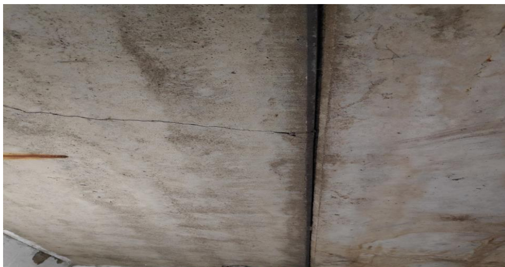
Рисунок 3.1 - Плиты с трещинами
